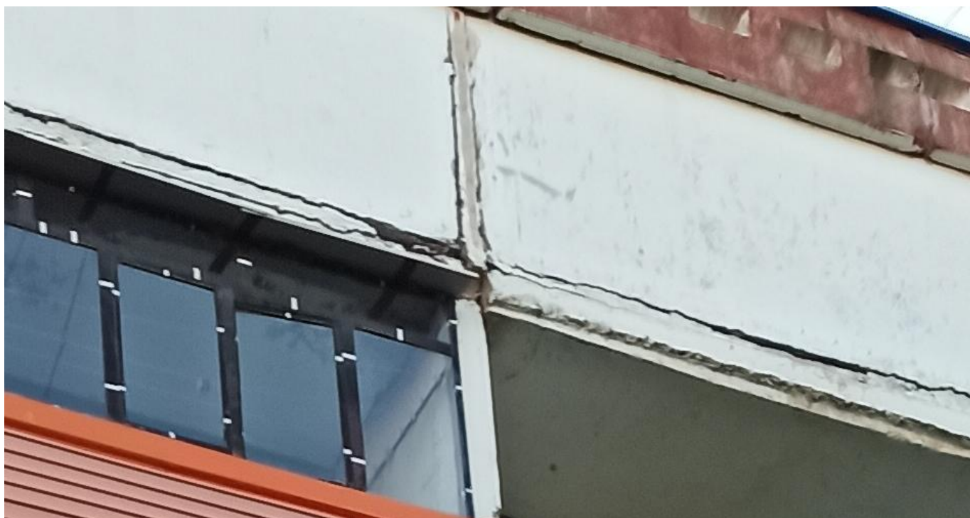
Фото 4.4. Фасад здания по оси V на уровне 5 и технического этажей. Опираение плиты перекрытия лоджии 5 этажа в осях V/Б-Г на простеночную панель сверху отсутствует, плита опирается только по 2 сторонами из 3. Просадка плиты на опоре до 5 см. Фото предоставлено Заказчиком.
