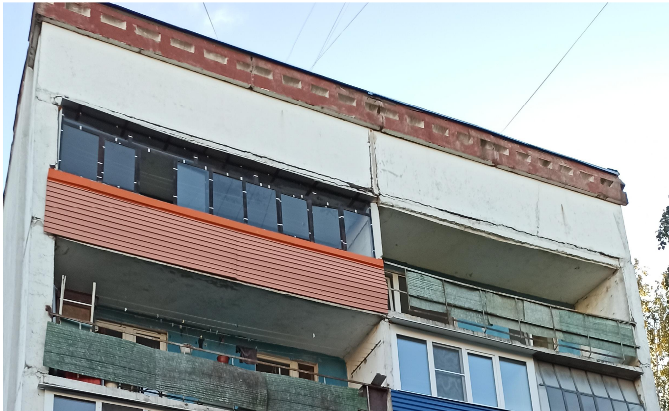
Фото 4.3. Фасад здания по оси V на уровне 5 и технического этажей. Плита перекрытия лоджии 5 этажа в осях V/Б-Г не опирается сверху на панель по оси Б, плита перекрытия лоджии 5 этажа в осях V/А-Г и стеновые панели технического этажа просели на средней стене, трещины стыков раскрылись, конструкции находятся в состоянии неустойчивого равновесия. Фото предоставлено Заказчиком.
