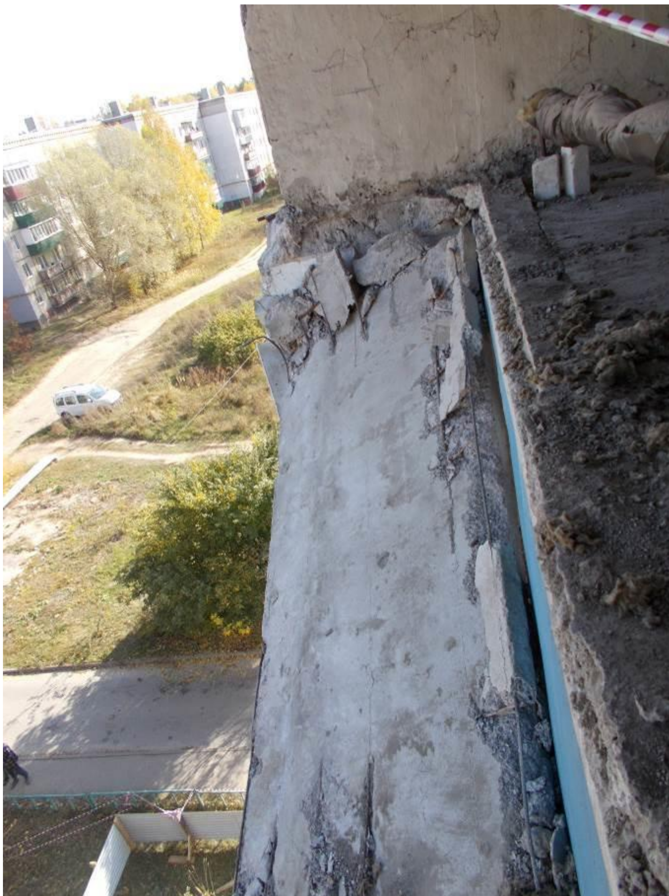
Фото 4.12. Плита перекрытия лоджий в осях V/А-Б.
