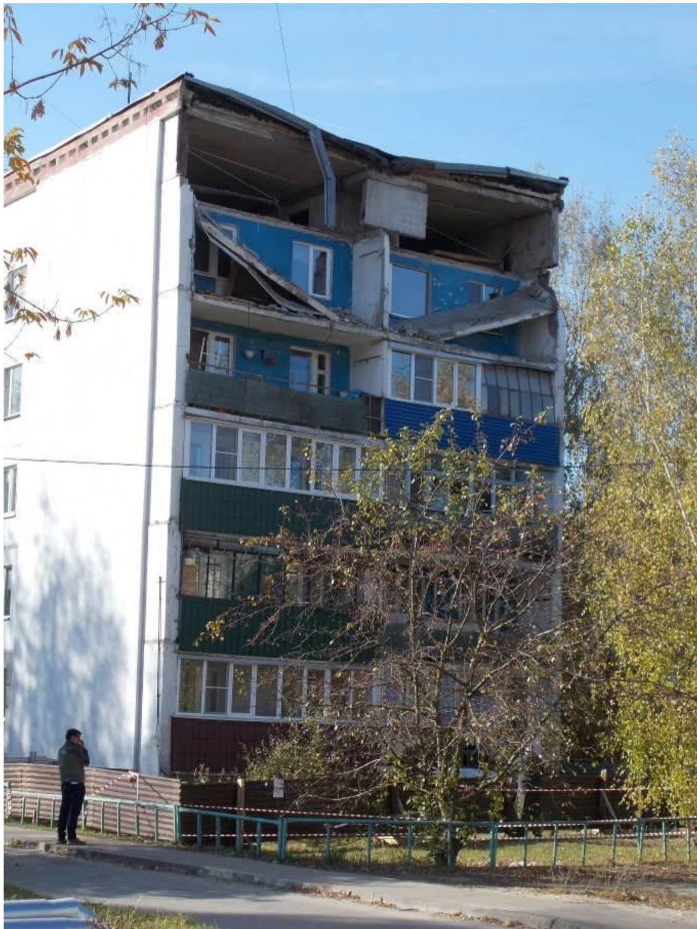
Фото 4.6. Фасады здания в осях V/A-Г. Последствия обрушения конструкций. Вид с восточной стороны.
